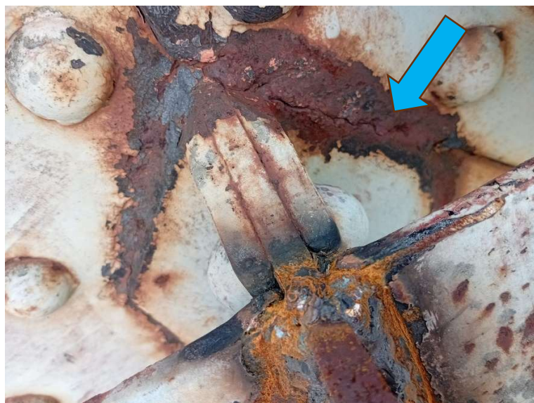
Unión soldada a cordón superior, fisurada
