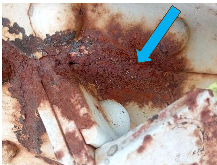
Unión soldada a cordón superior, fisurada
