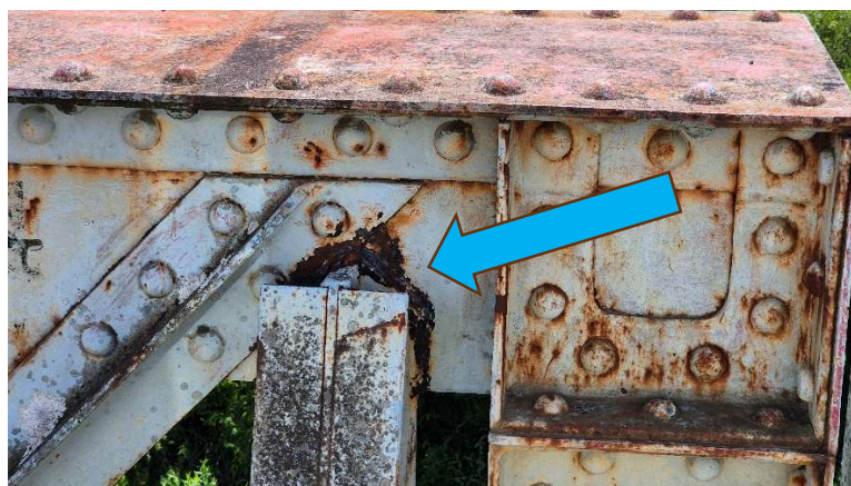
Unión soldada a cordón superior, con corrosión
